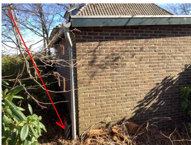
Restanten vlakke plaat tegen de achterzijde van de schuur
