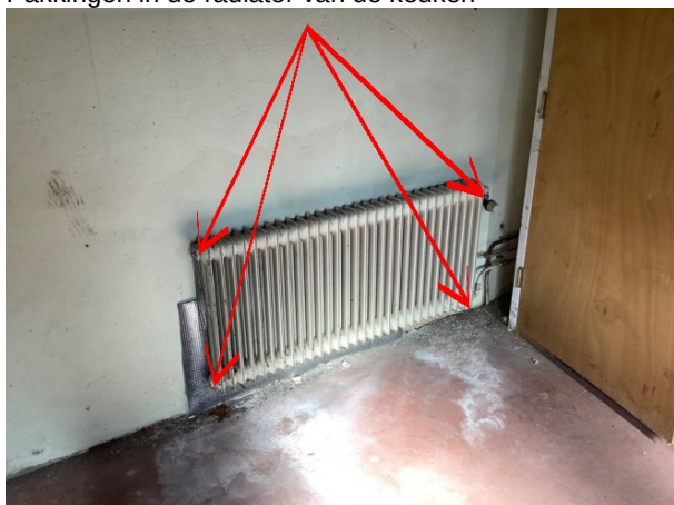
Pakkingen in de radiator van de schuur
