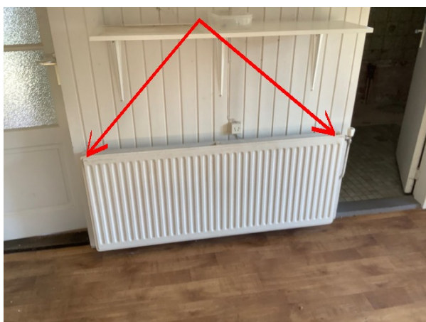
Pakkingen in de radiator van de keuken
