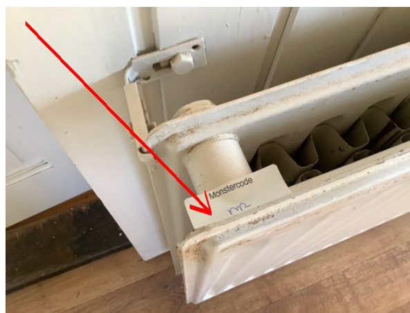
Pakkingen in de radiator van de keuken
